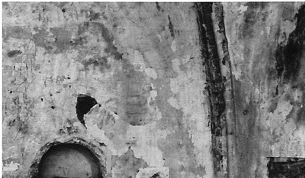
Przykład stanu zachowania lica ściany
